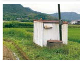
経年による故障が心配されるポンプ施設
