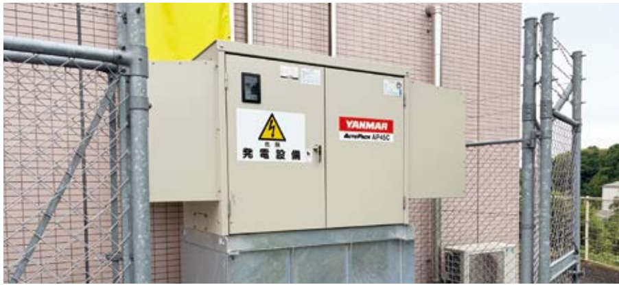
コンパクトになった発電設備(仲南サブセンター)
