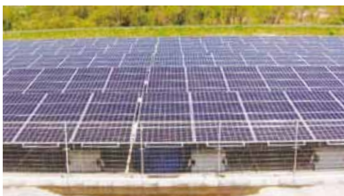
設置されている太陽光発電パネル
