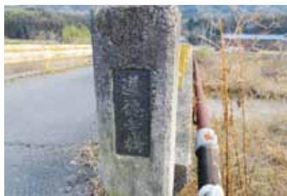
老朽化した道德寺橋
