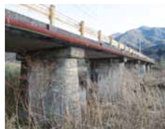
老朽化の進んだ橋
