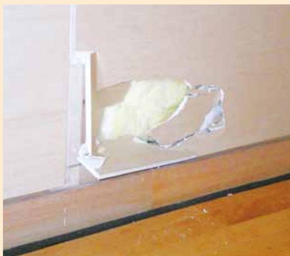
破損した体育館の内壁
