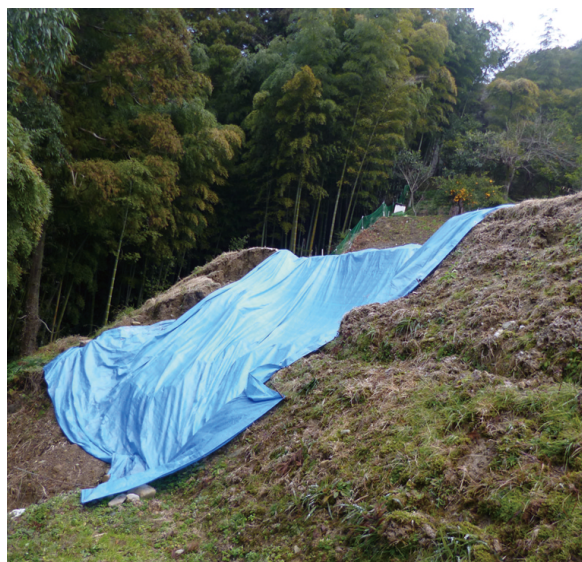
台風で崩壊した田んぼの法面
