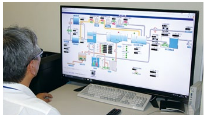
常時、配水状況をモニターでチェック
