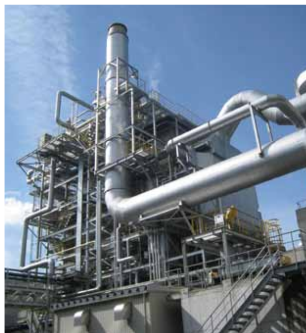
バイオマス発電所 真庭市
