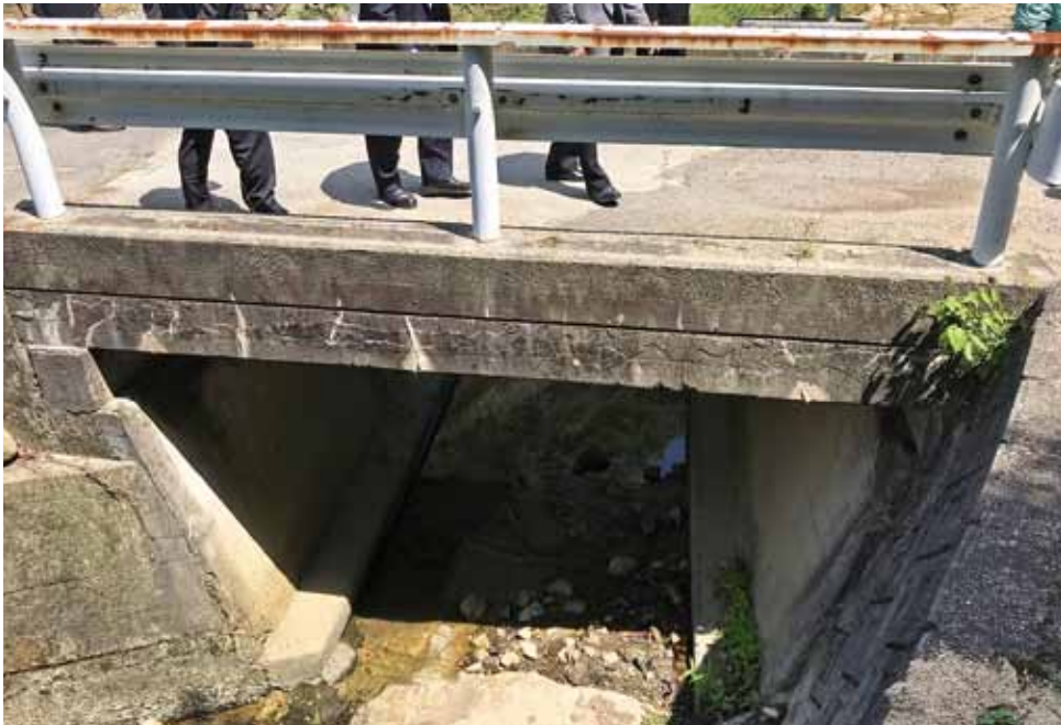
傷んだ林道大井手線の橋梁
