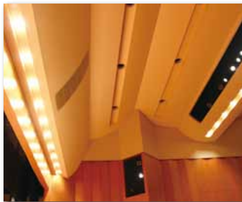
改修を待つ吊り天井（町民文化ホール）
