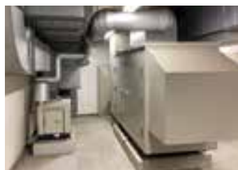
地下室にある非常用発電機
