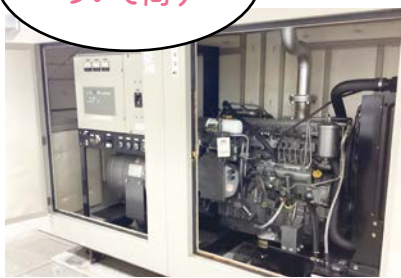
有価物である発電機を特別管理廃棄物として高額な処分料を支払い処分したものと類似の現在も使用中(40時間)の同年代の発電機(役場庁舎の地下室で稼働中)
