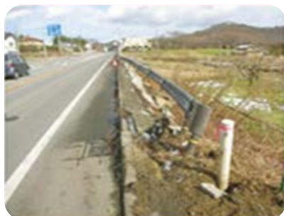
ガードレール・ 標識等の損傷
